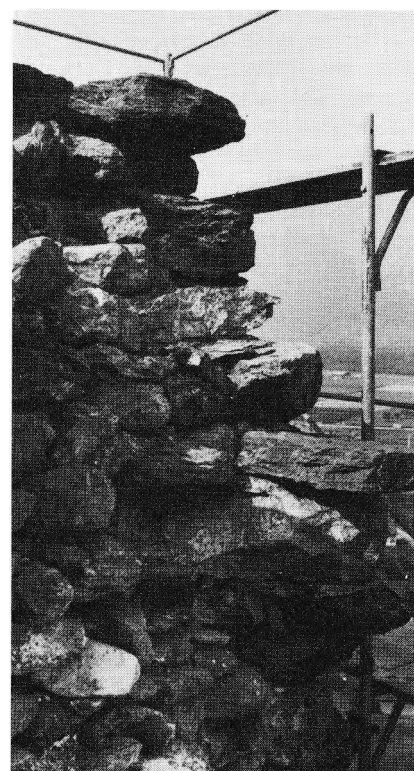
Auch beim Bergfried befand sich das Mauerwerk zum Teil in bedenklichem Zustand.
